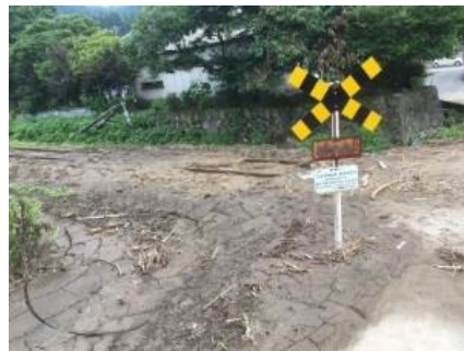
こちらは橋が流されてその上を走る線路が破壊されています
